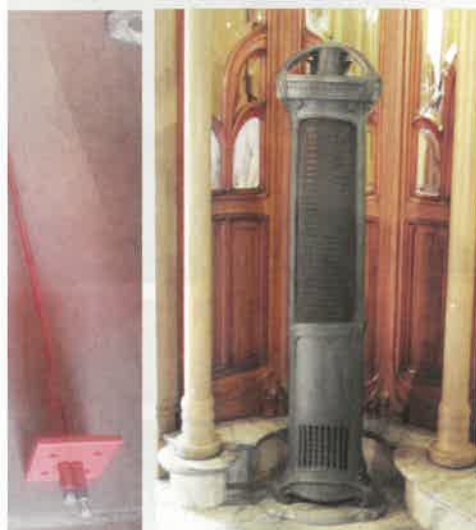
en fonte restauré. Il comporte 2 tuyaux (le plus court pour le retour). Ce est installé verticalement avec un petit purgeur, dans la banquette.
